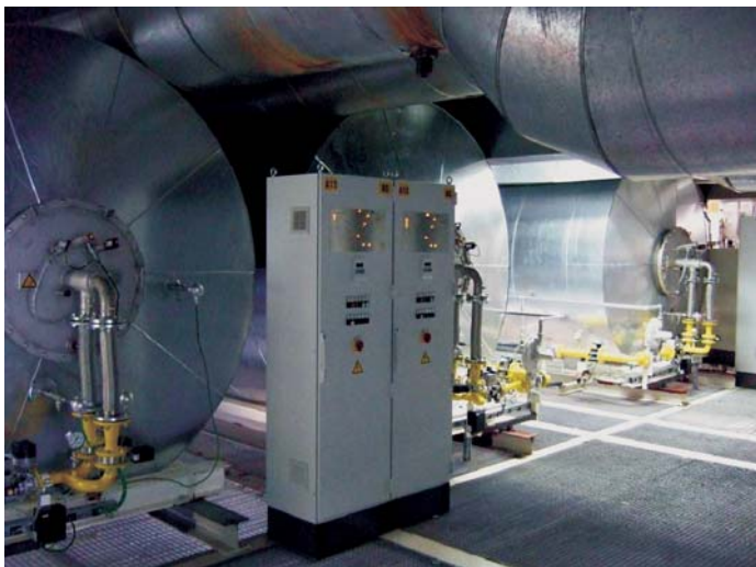
Bild 3: TNV, TRICOM Brenner und Schaltschrank einer TNV bei VW in Emden
